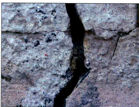
Trhlina v tělese komína!!
