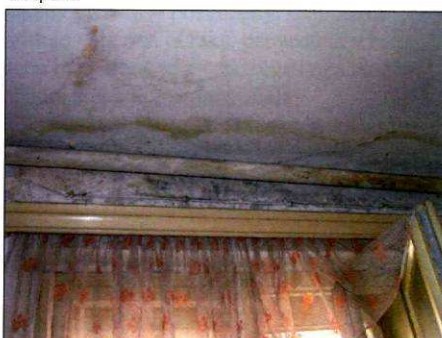
Plíseň v místě zatékání
