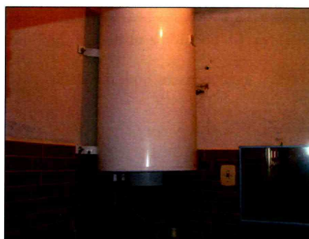
Elektrický bojler v koupelně
