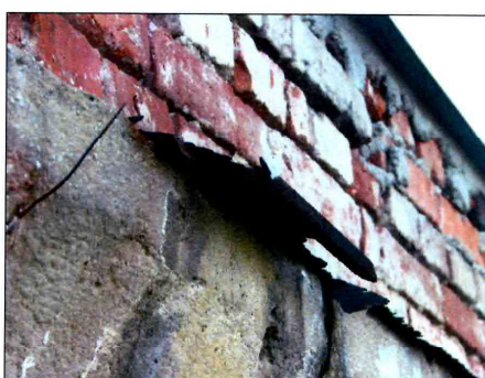
Dožitě klempířské konstrukce
