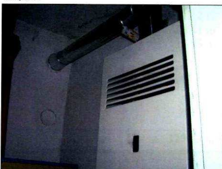
Plynový kotel ÚT
