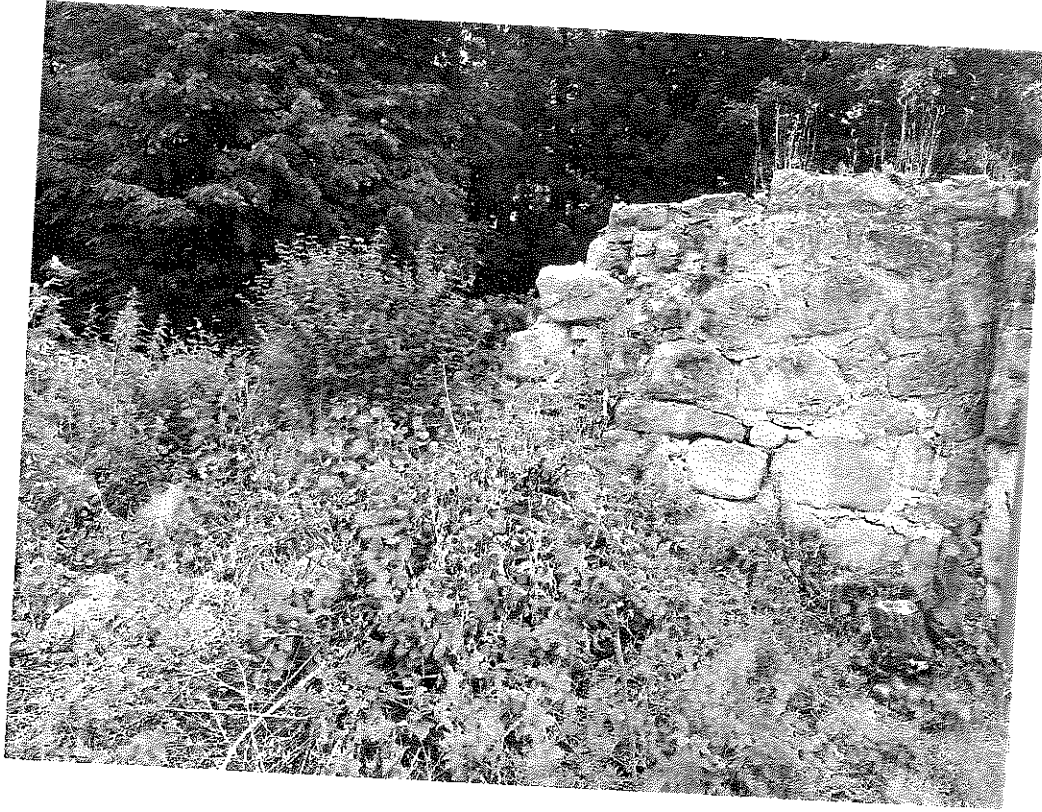
Foto 6 Zbytky původního pískovcového zdiva Hrozba zřícení zdiva
