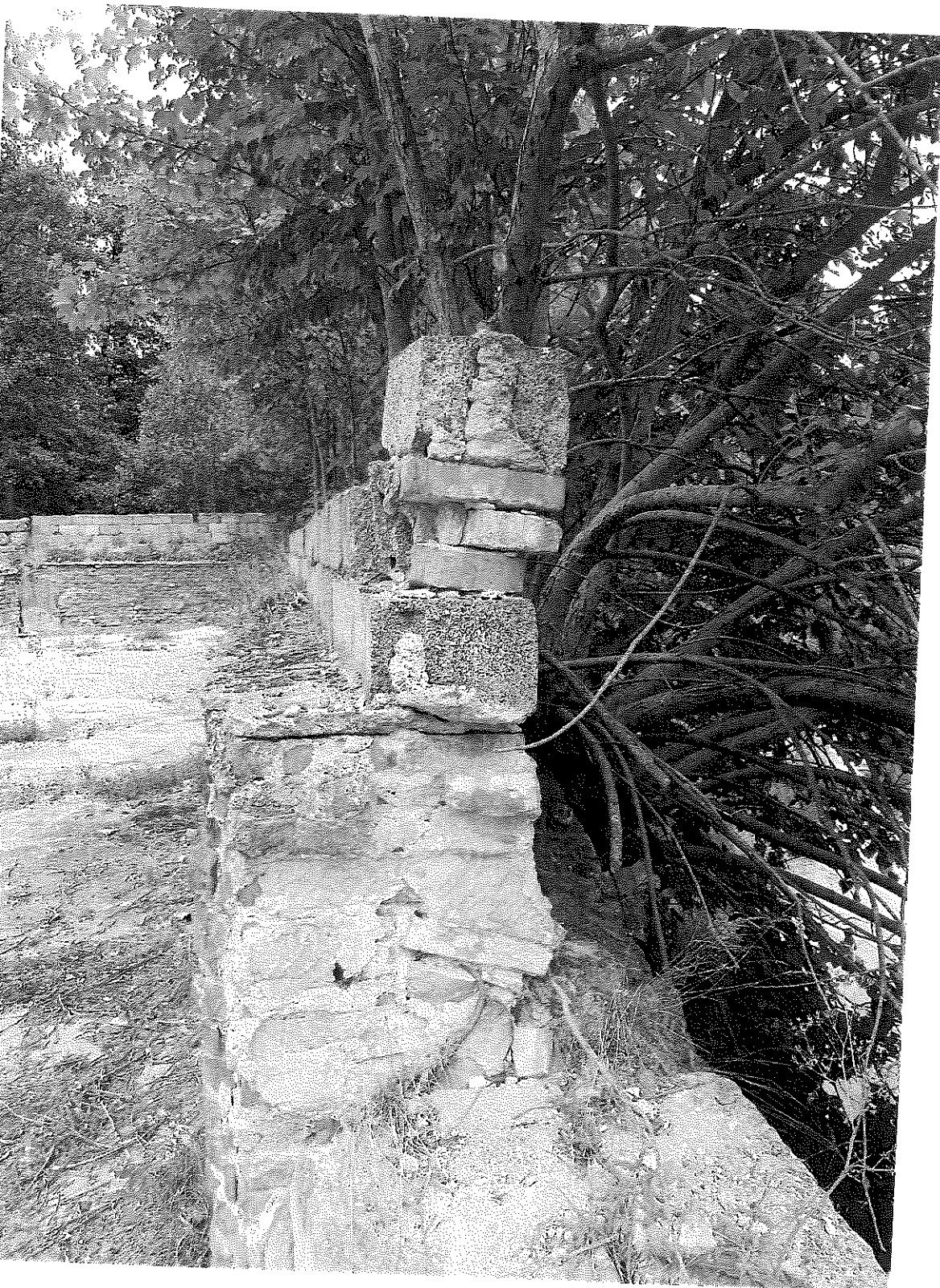
5 Hrozba zřícení zdiva
