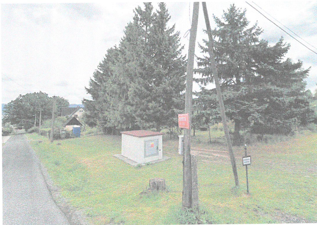
01 Křížení ulic Irkutská a Strakonická s trafostanicí obsluhující lokalitu.
